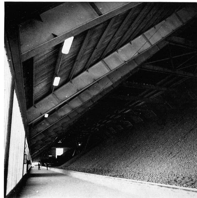
Átlagosító nyersanyagtároló belső képe
