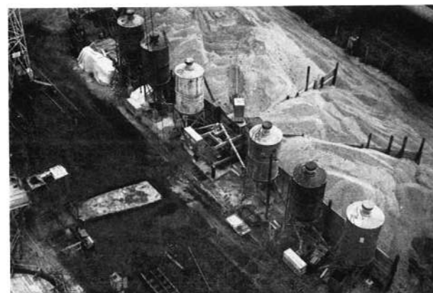
Betonüzem a ceglédi siló építésénél jól látható a frakciók szerint osztályozott adalékanyag, a centrális elhelyezésű Elba-Mixer típusú keverőgép, a cementsilók, a toronydaru a betonüzemtel közvetlenül emeli konténerrel be a betont a bedolgozás helyére
