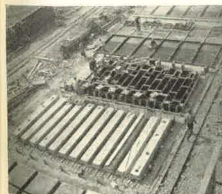
Az épülettel párhuzamosan elhelyezett előregyártó területen megfigyelhető az előregyártás folyamatossága. Ebben a sorban utolsóként a faltáblák készülnek.
