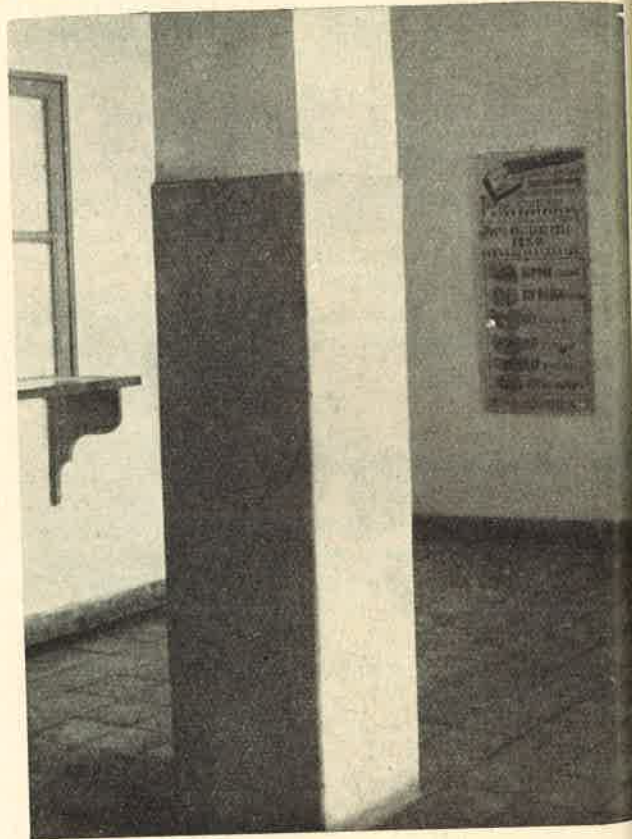
24. ábra. Előcsarnoki pillérburkolat felhordott műköből A tervtől eltérő kivitel hatása igen kedvezőtlen
