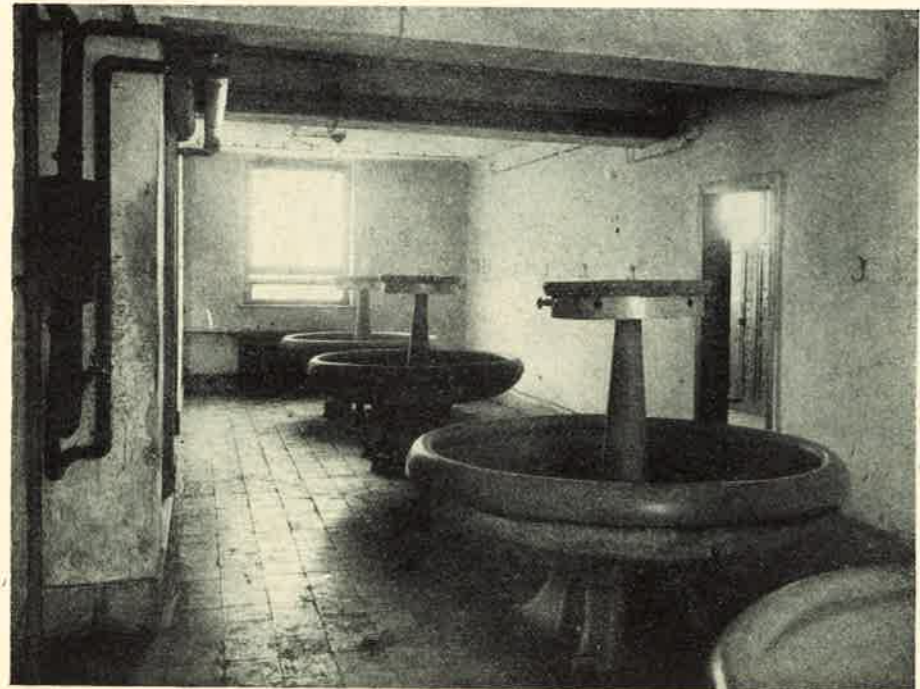
22. ábra Szellőzőművek mosdóhelyiség Körmosdós elrendezés, a körmosdók csapjai jórészt hiányoznak. Mosdó-zuhany közös légterben. Radiátor, érintésvédelem hiányzik. Tisztasági szempontból nagyon elhanyagolt állapotban levő mosdó. A mosható falburkolat nem nélkülözhető
