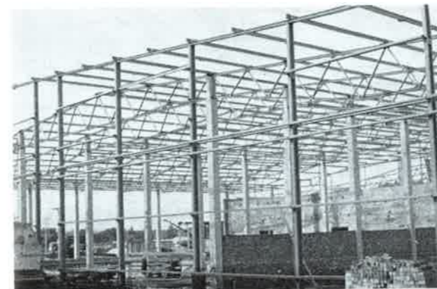
3. ábra. Mélyhűtőház, Halle, NDK (70)
